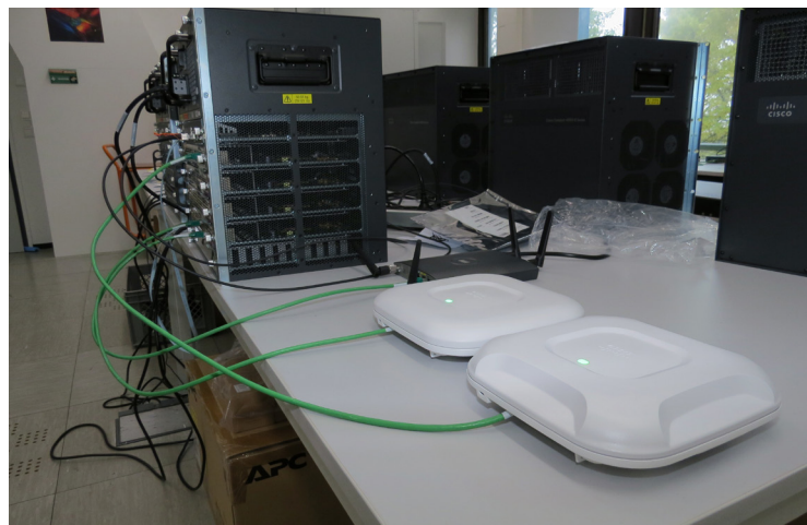
Switch mit angeschlossenen Access-Points
