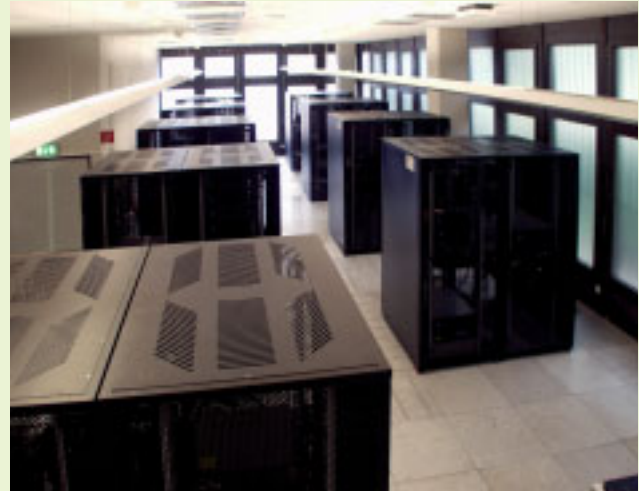
Abb. 13: Blick über die Racks in Maschinensaal I
