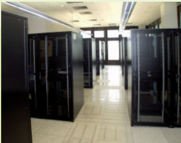
Abb. 12: Der Maschinensaal I in Gebäude P.05
